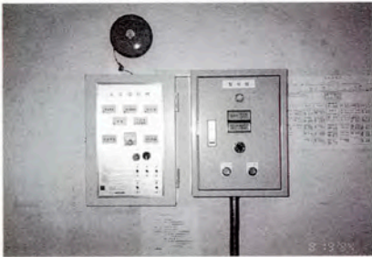
火災受信装置
