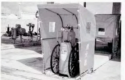
充填場の大型消火器
