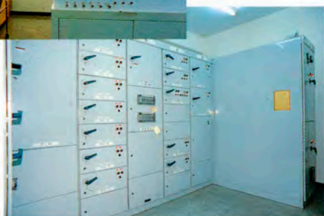
電気室内の低圧分電盤
