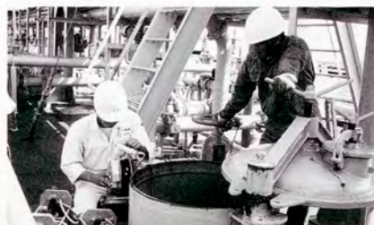
船槽の電導率を測定
