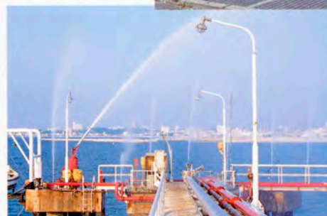
栈橋消火設備と機能点検
