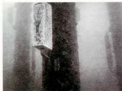
海中の栈橋脚柱に設置されたアルミニウム合金陽極
