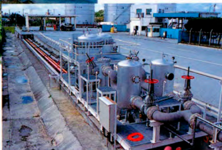
搬入設備の主要機器と配管
