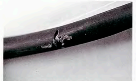
白蟻による食害を受けた電気配線
