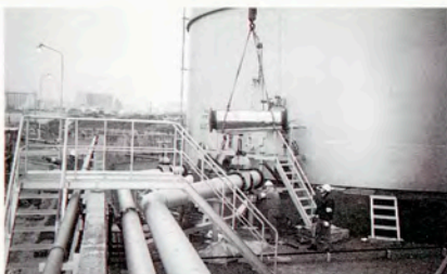
配管の縁切り
