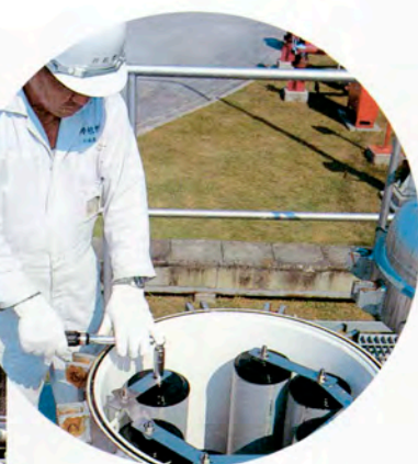
フィルターセパレーター 開放検査
