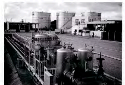
燃料流通系の設備
