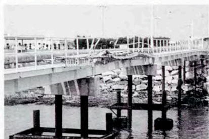
棧橋渡り歩廊の損傷状況
