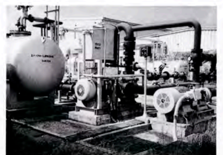
消火設備ヤード
