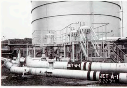
搬入配管のグレードマーク
