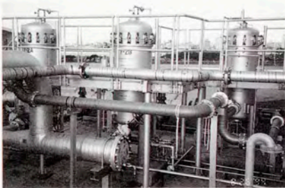
搬出ラインのフィルターセパレーター
