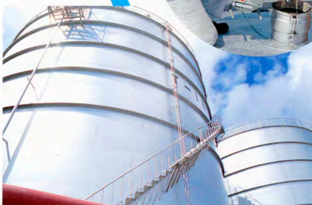
消費燃料10日分を貯蔵する主タンク
