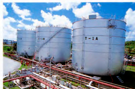
燃料貯蔵設備の主タンク (3,413 \text{k}\ell ) 3基
