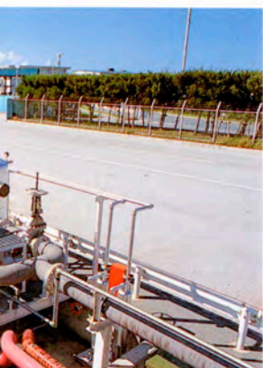
燃料搬入ラインの 機器類と配管
