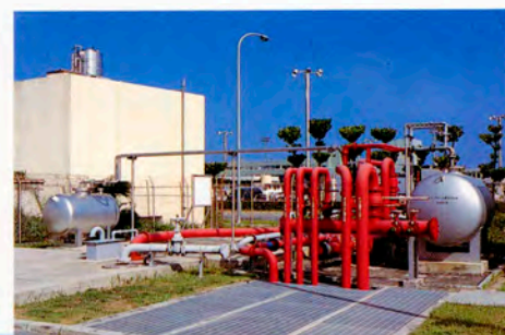
消火設備ヤード
