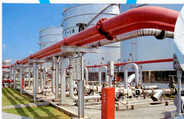
燃料搬出ヤードの配管と機器類
