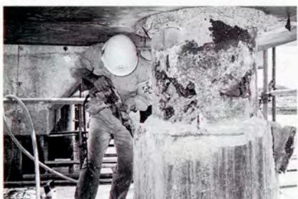
脚柱部の損傷状況
