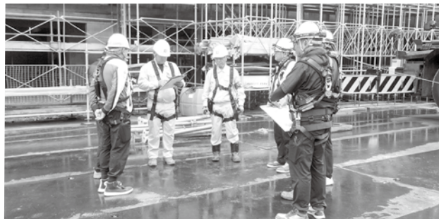
安全対策を確認した指摘。土木現場では作業通路の確保や開口部養生などについて改善を求めた。
