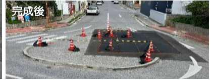
令和 5 年度宮城 4 号線排水路改修 設計業務委託 （北谷町役場）
