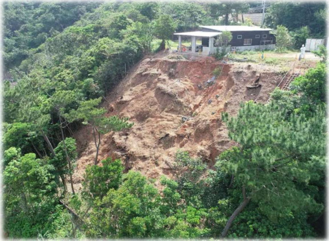
台風で崩壊した斜面
