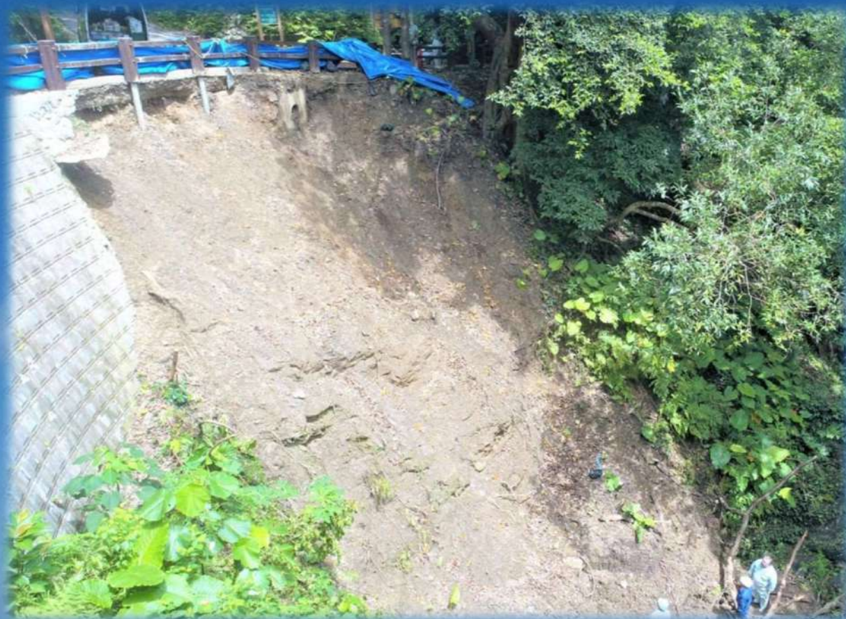
台風で崩壊した法面
