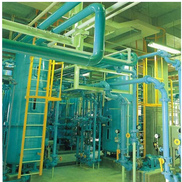
石川石炭火力発電所（純水製造装置）
