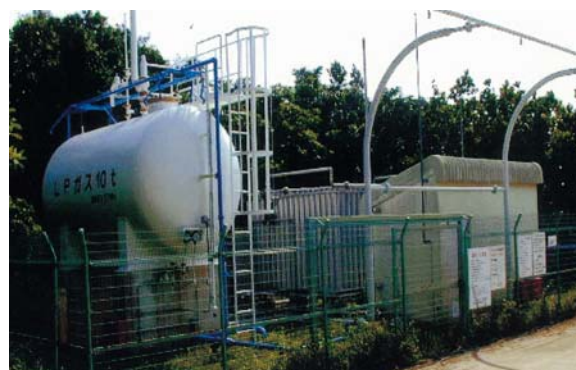
読谷リゾートLPガス供給施設
