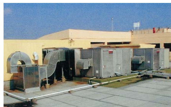
ミハマセブンプレックス空調設備
