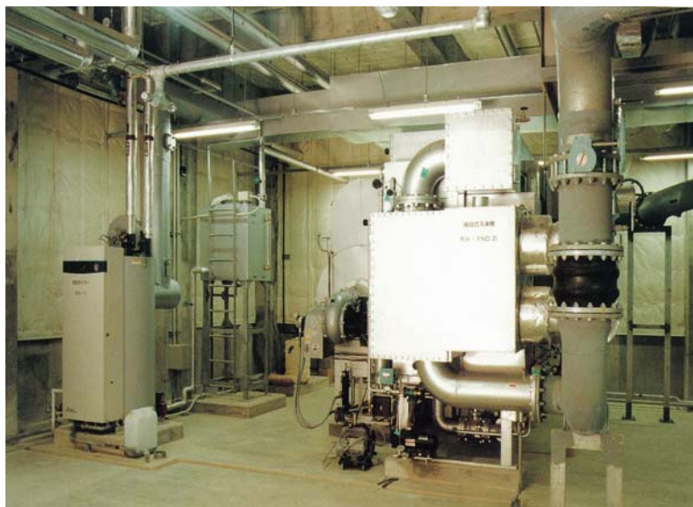
ザ・ブセナテラス機械室(平成9年)
