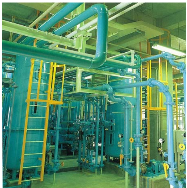
石川石炭火力発電所（純水製造装置）
