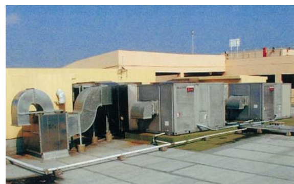
ミハマセブンプレックス空調設備
