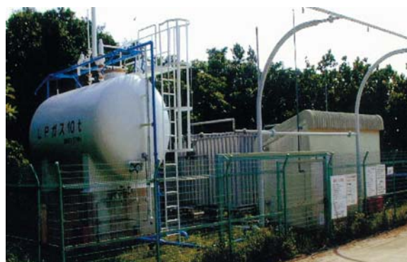
読谷リゾートLPガス供給施設
