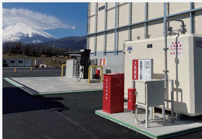
静岡県 自家用給油所
