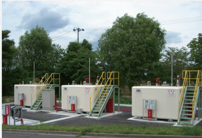
宮城県 緊急発電用
