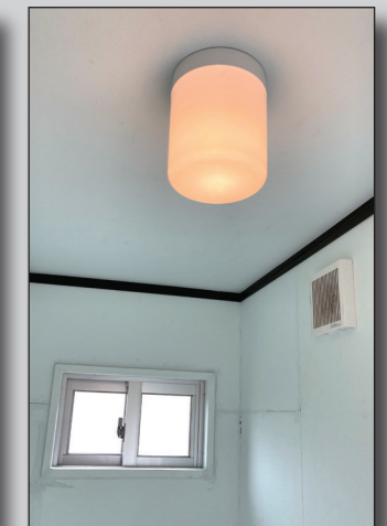
照明・換気扇
