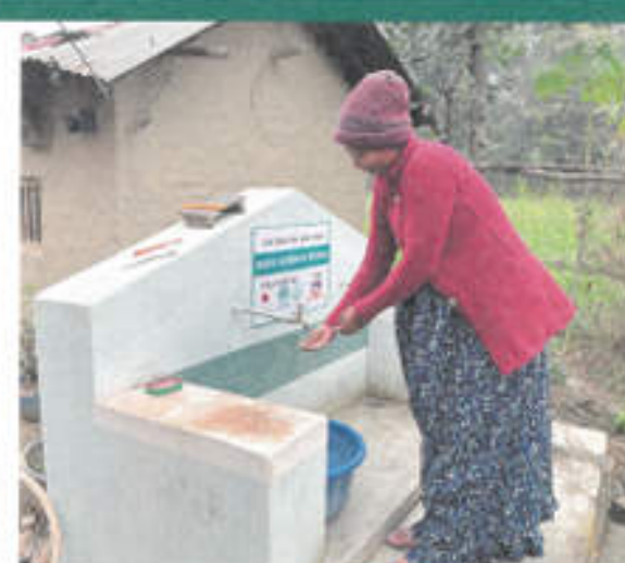
ビジャヤナガル村にて高架水槽を導入し、新しく設置した水栓から水が出るようになった。
